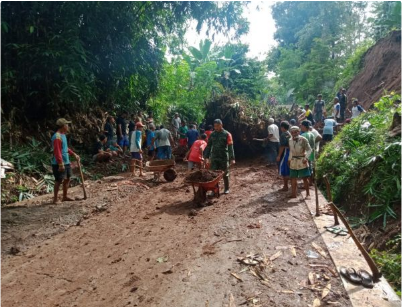
Babinsa Koramil 07/Kejobong bersama masyarakat mengevakuasi longsor rumpun bambu yang tutupi ruas jalan di Dusun Pagerjirak Desa Kejobong (FOTO: Pendim 0702/Purbalingga)
